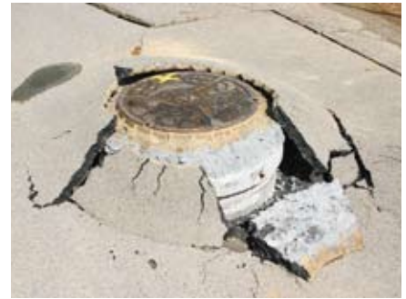
マンホールが浮いた
